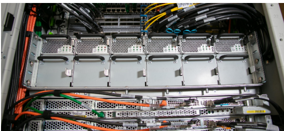
Abbildung 3: AWS Outposts AC/DC-Stromversorgungen und Stromverteilung über Sammelschienen
